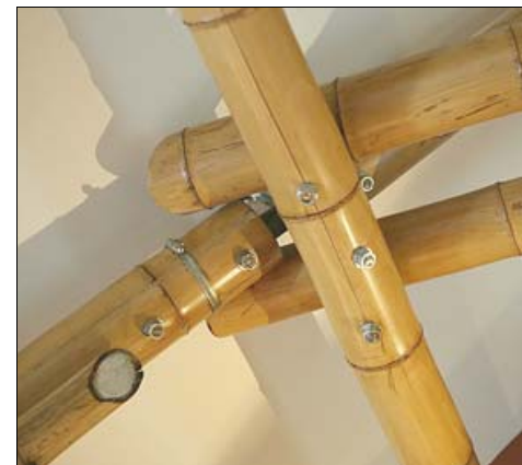
De bamboestengels worden eenvoudig aan elkaar gekoppeld met moeren en bouten. Ter hoogte van de verbinding wordt de stengel opgevuld met cement
